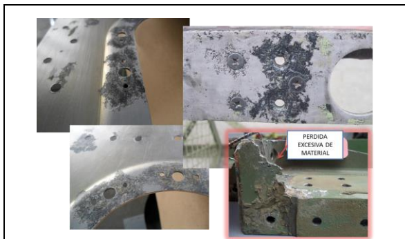
Figura 1. Deficiencias en el Control y Prevención de la Corrosión, estados de corrosión severa
