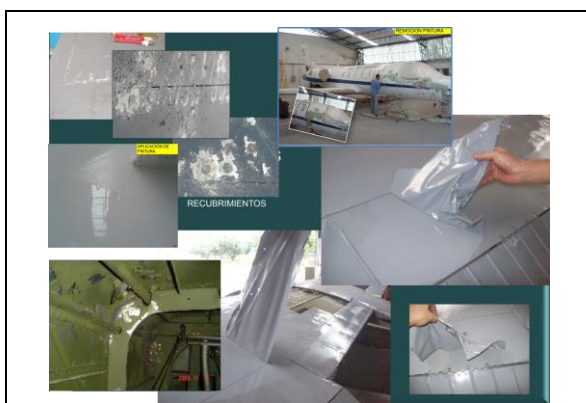
Figura 5. Deficiencias en la aplicación de recubrimientos orgánicos. Preparación de superficie
