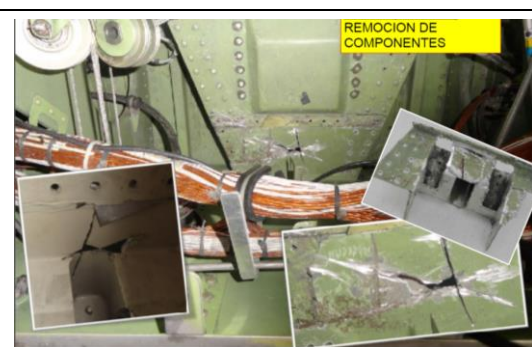
Figura 12. Remoción inapropiada de componentes estructurales, utilización de procedimientos no establecidos
